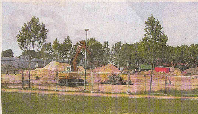
Wentorf. Die Bagger rollen bereits auf dem Grundstück, wo eine 6.000 Quadratmeter große Ausstellungsfläche entsteht. Foto: Körte
